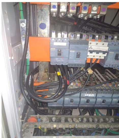
Disjuntor instalado no "QGBT-Térreo"
